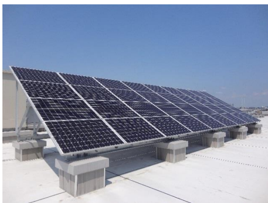
太陽光パネル
