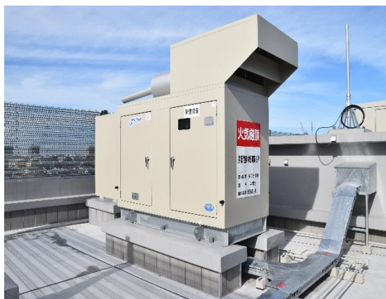
非常用自家発電設備
