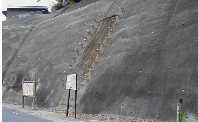
図4-1-1 地蔵堂化石帯の状況
