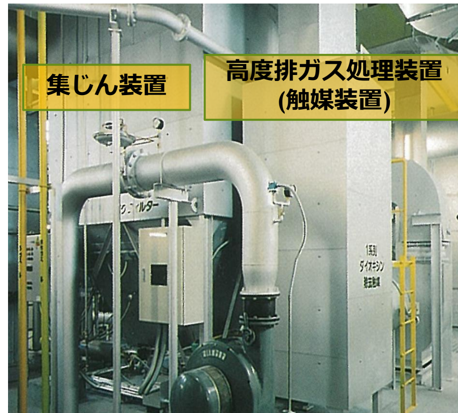
排ガス処理設備の例
