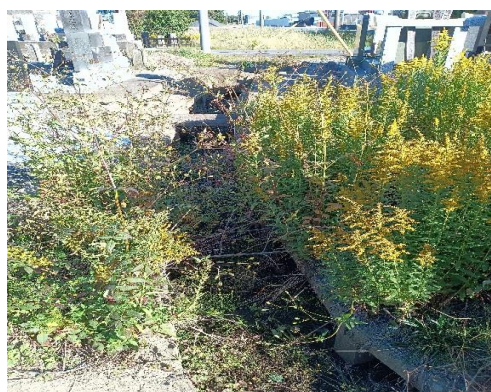
・既存の汚泥に埋まった排水路
