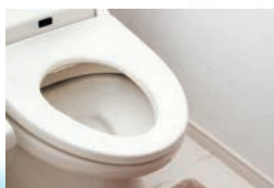
トイレのつまり・水漏れ
