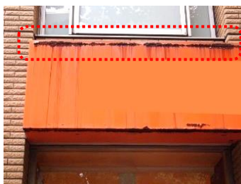
その他（塗装剥離、腐食など）
