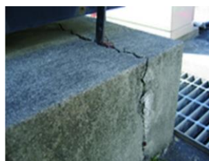
基礎にクラックが入った状態
