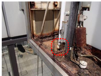
蛍光灯のホルダーが破損した状態
