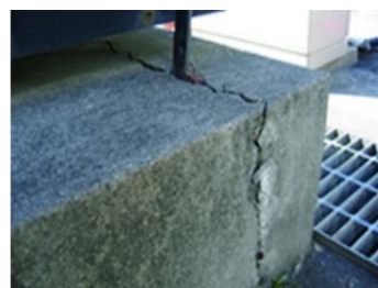
基礎にクラックが入った状態
