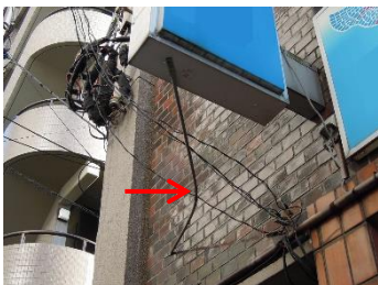
振れ止め棒が変形した状態
