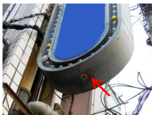
水抜き孔が詰まった状態
