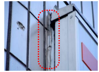
コーキングが劣化した状態
