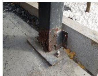
支柱根元の腐食が進行した状態
