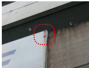
金具が劣化した状態
