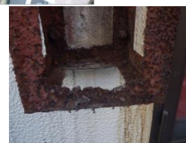
支持部が腐食していた看板の例
