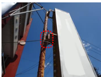
支柱・広告板接合部の腐食・隙間
