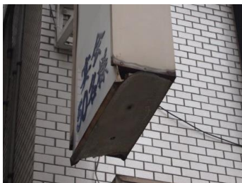
その他 （塗装剥離、腐食など）
