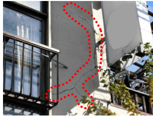
壁面にひびが生じた状態
