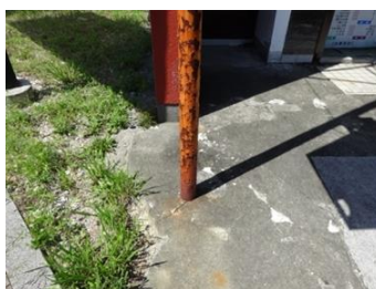
支柱の腐食が進行した状態
