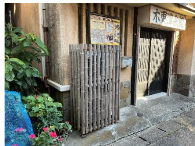
エアコン室外機を自然素材で隠す（木更津会館）
