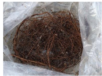
取付管内部に侵入した根
