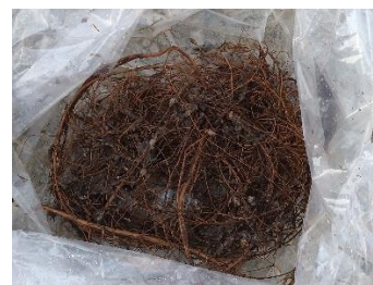
取付管内部に侵入した根
