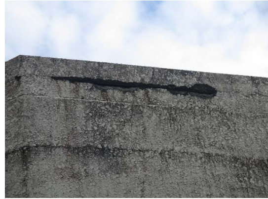
外壁の露筋 全体的に汚れが目立つほか、ところどころで壁面クラックや、露筋などの劣化が進行中
