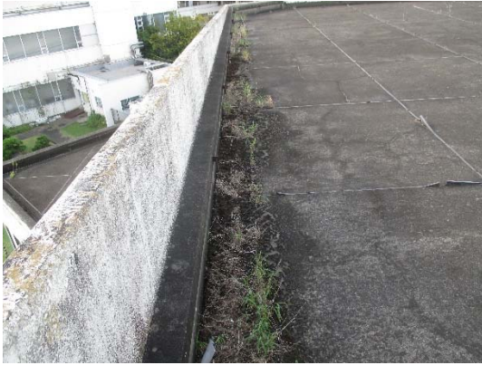
屋上面老朽化 経年劣化が進行している
