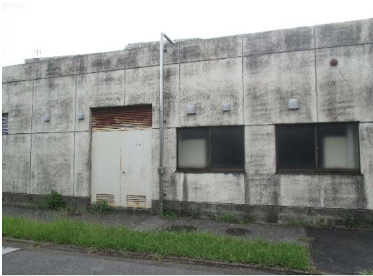
外部開口部の錆 経年劣化が進行している
