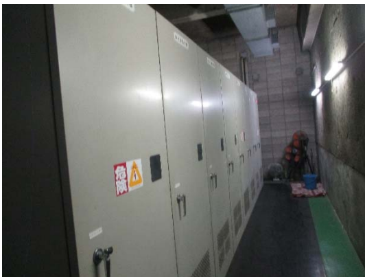
大ホールの電気室 給排水と電気は、供用休止中の大ホールの機械室・電気室、受水槽から分配されている
