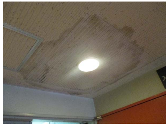
雨漏り跡 2 か所で見られたが、雨漏りによるものかどうかの詳細は要調査
