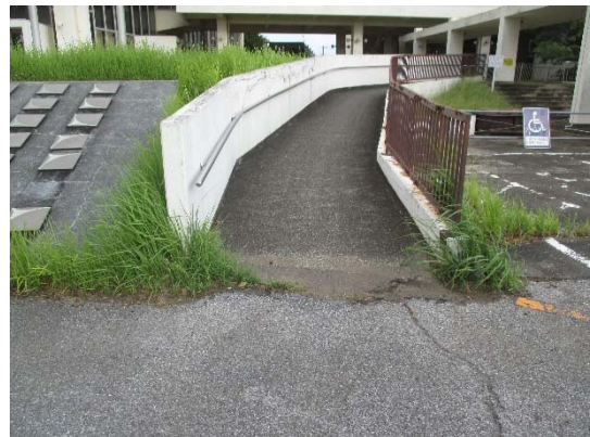
バリアフリー通路 あまり良好な状態ではない
