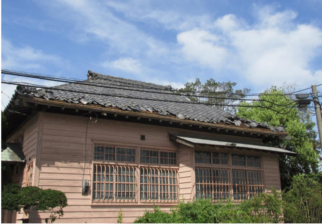
台風 15 号の強風により、屋根瓦の一部が外れ落下した。
