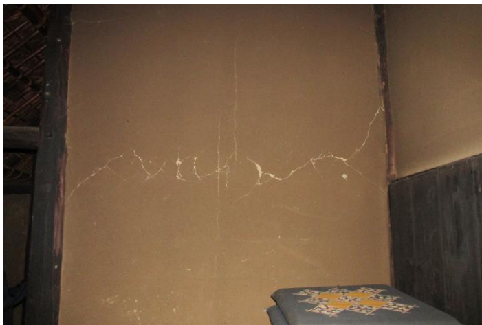
納戸（今回の地震により破損が拡大した。）
