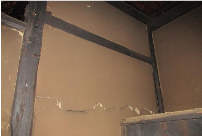
仏間（今回の地震により破損が拡大した。）
