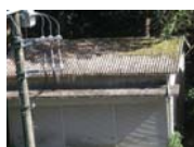
屋根の雑草繁茂（車庫）
