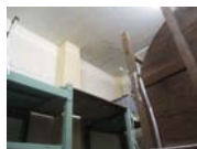
雨漏りの疑い（新収蔵庫）
