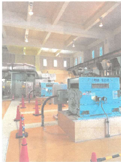
親松排水機場のポンプ室
