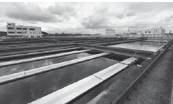
小櫃川より取水の大寺浄水場
