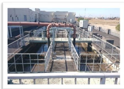
木更津下水処理場 1系水処理施設
