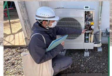
工事において適正に試験され、規定値内であることを確認します。
