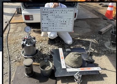
コンクリートの打設前に行う材料の検査に立会います。 (配合・スランプ等の確認)
