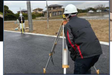
宅地分譲等の開発の完了検査時にレベル測量を行っている様子です。
