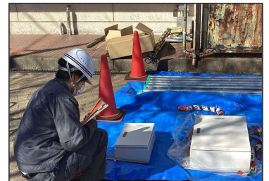
承諾した計画の機器が搬入されていることを確認します。
