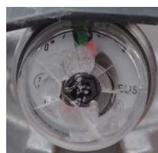
× 指示圧力計の損傷
