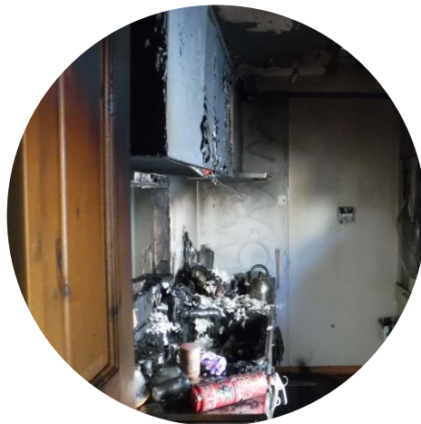
焼損した台所
