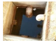
木更津駐屯地の 油水分離槽
