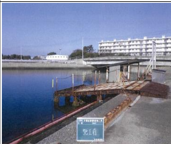
船揚げ場等補修 施行前② (新木更津市漁業協同組合 木更津本所)
